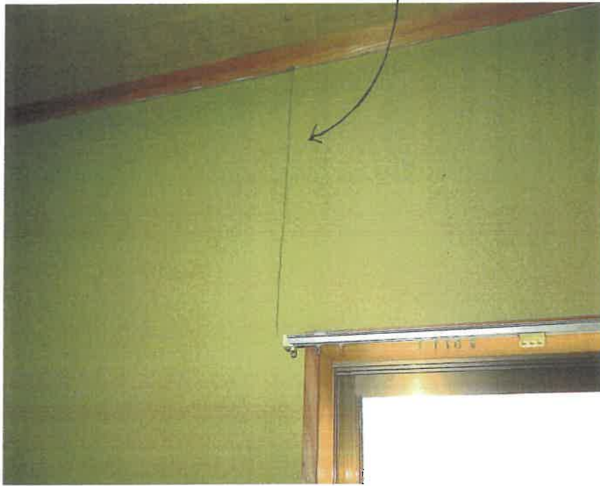
天井付近の壁にある亀裂
