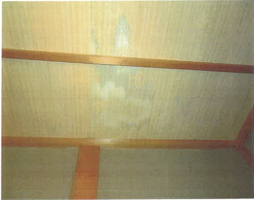
天井にある雨漏り跡のようなシミ
