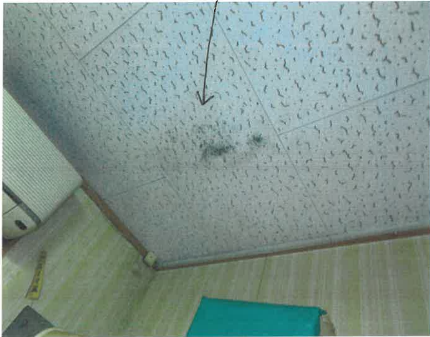
天井にあるシミと汚損
