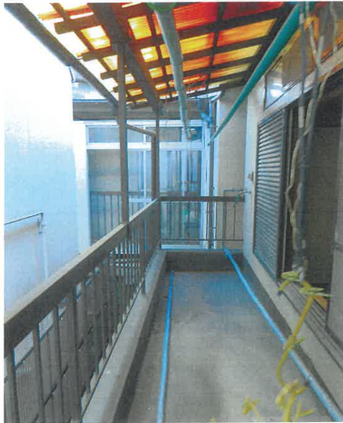
変色し劣化した屋根
