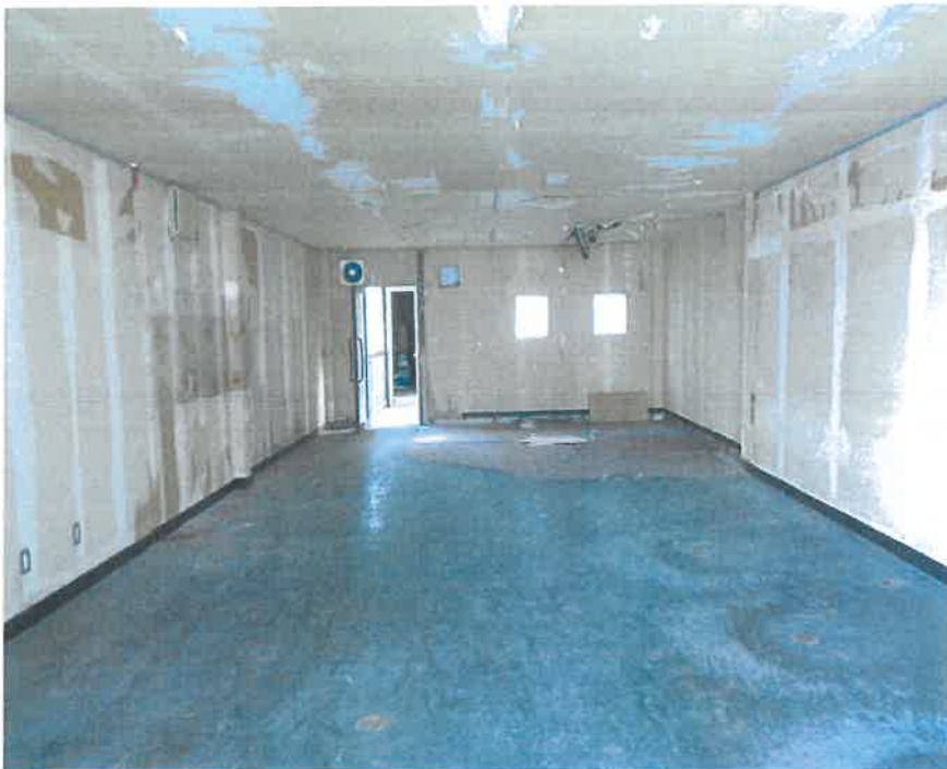
壁・天井のクロスが剥がされたままの状態
