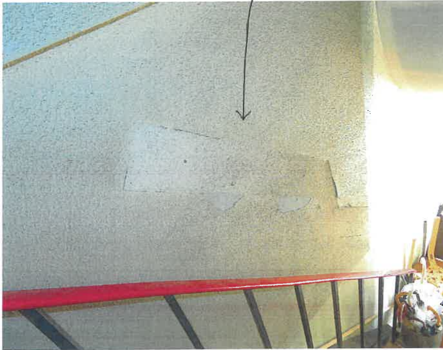
壁にある損傷
