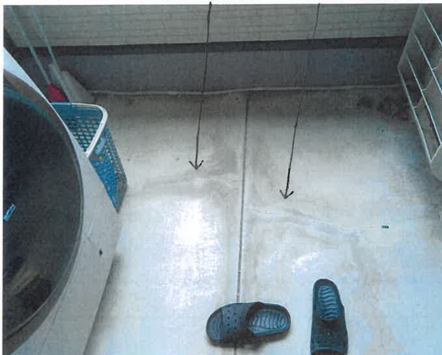
ベランダの床にある細い亀裂のような線
