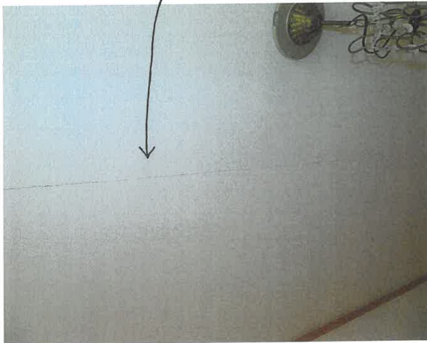
天井に細長く走っている亀裂
