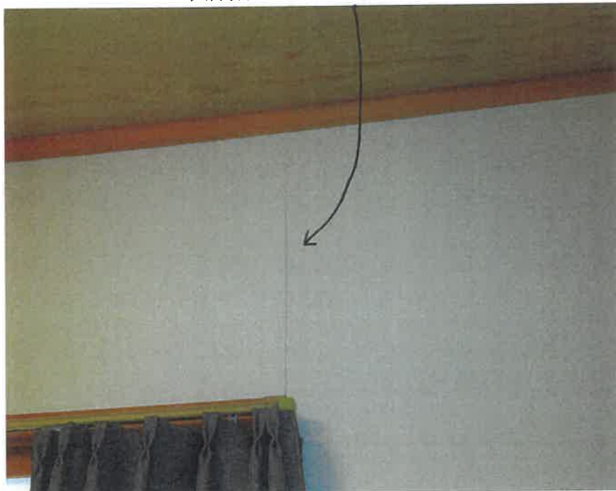
天井付近の壁にある亀裂
