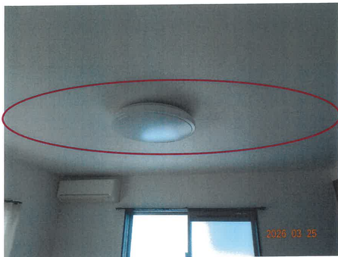
⑨天井の亀裂
