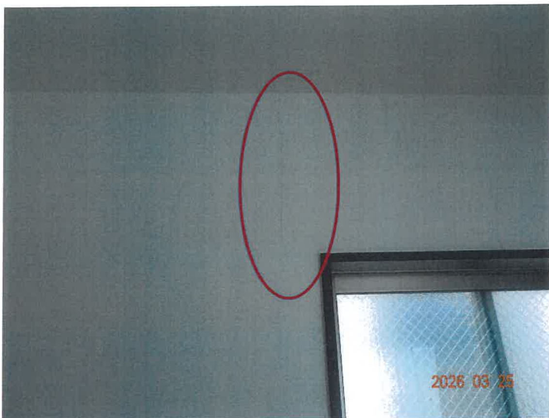
⑦ 壁の亀裂
