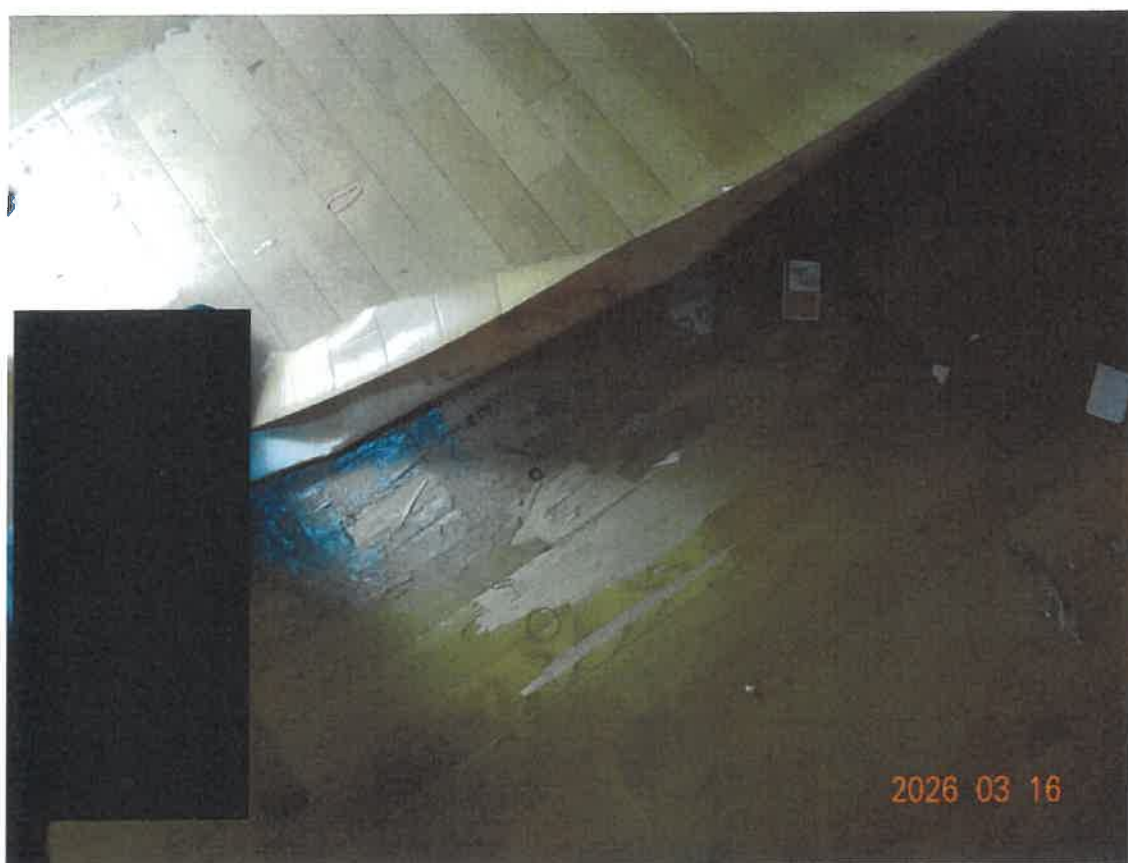
⑪床の損傷部分
