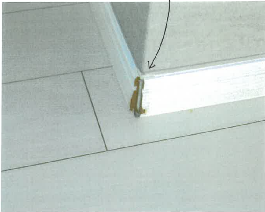
巾木部分の損傷
