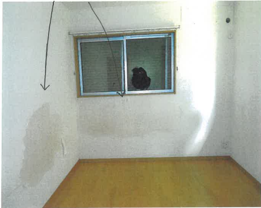
壁クロス剥離
