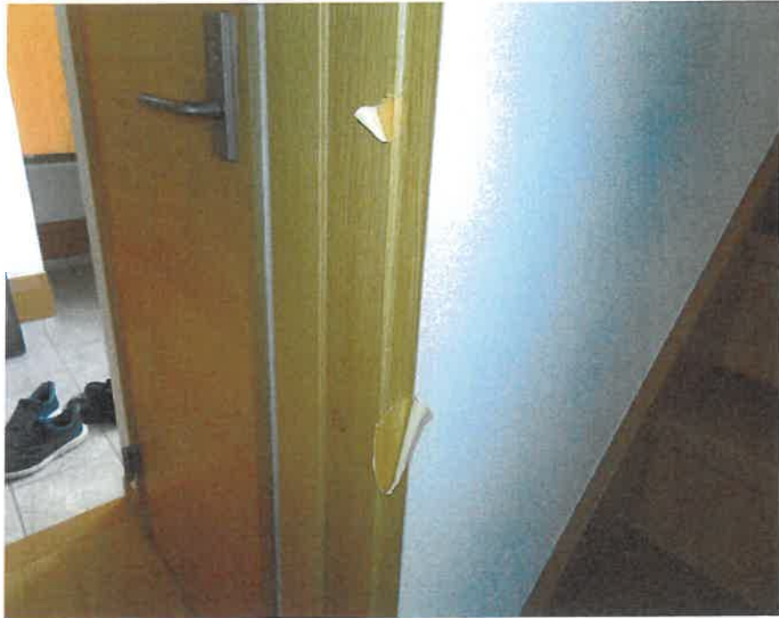
クロスの剥離
