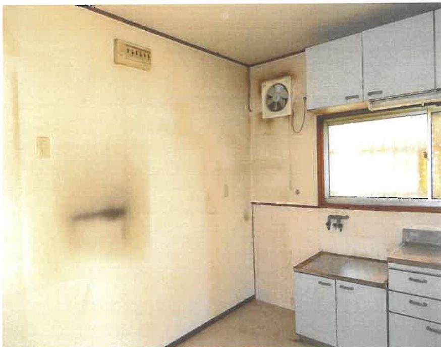
全体的な壁の汚れ
