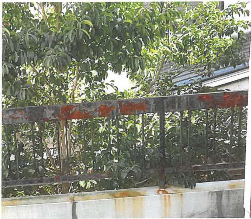
バルコニーの鉄部の腐食(錆び)
