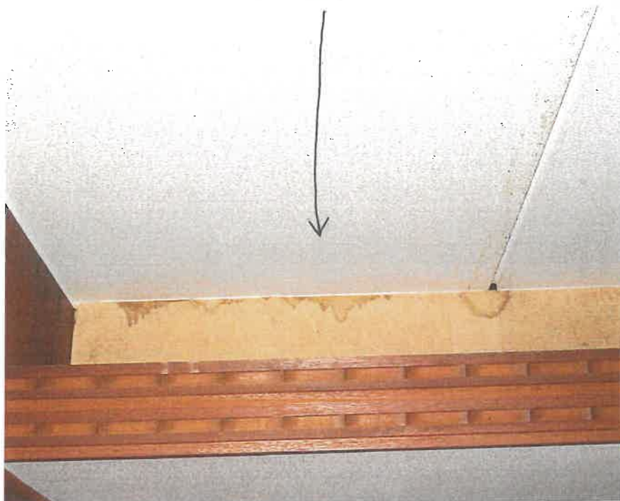
天井付近の雨漏り跡のようなシミ
