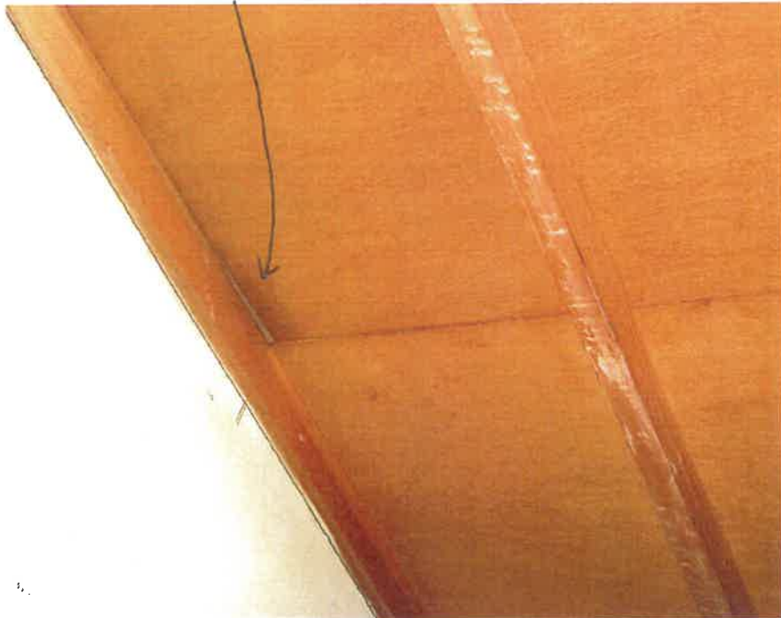
天井板の浮き
