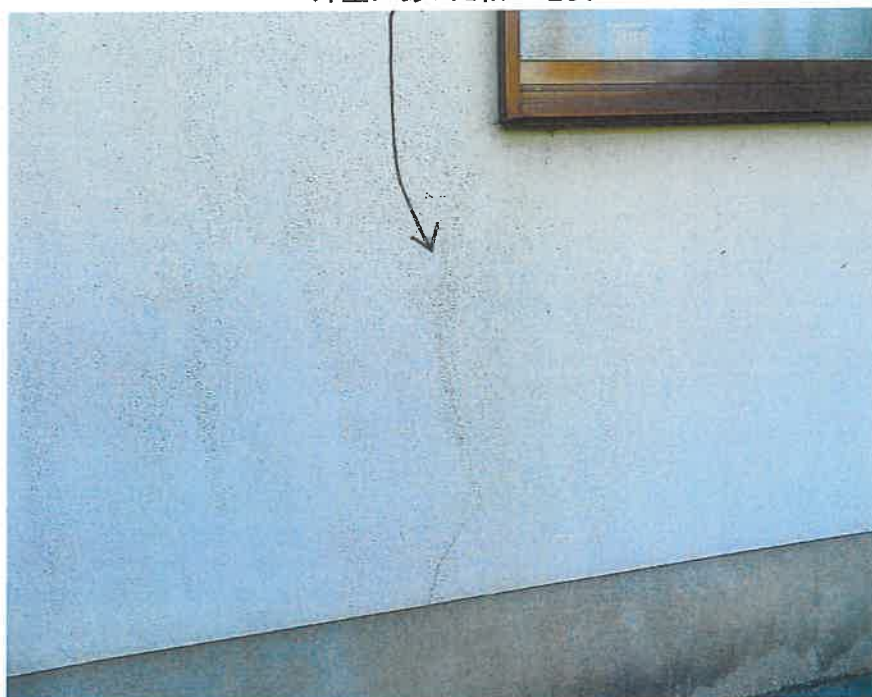
外壁にあった細い亀裂
