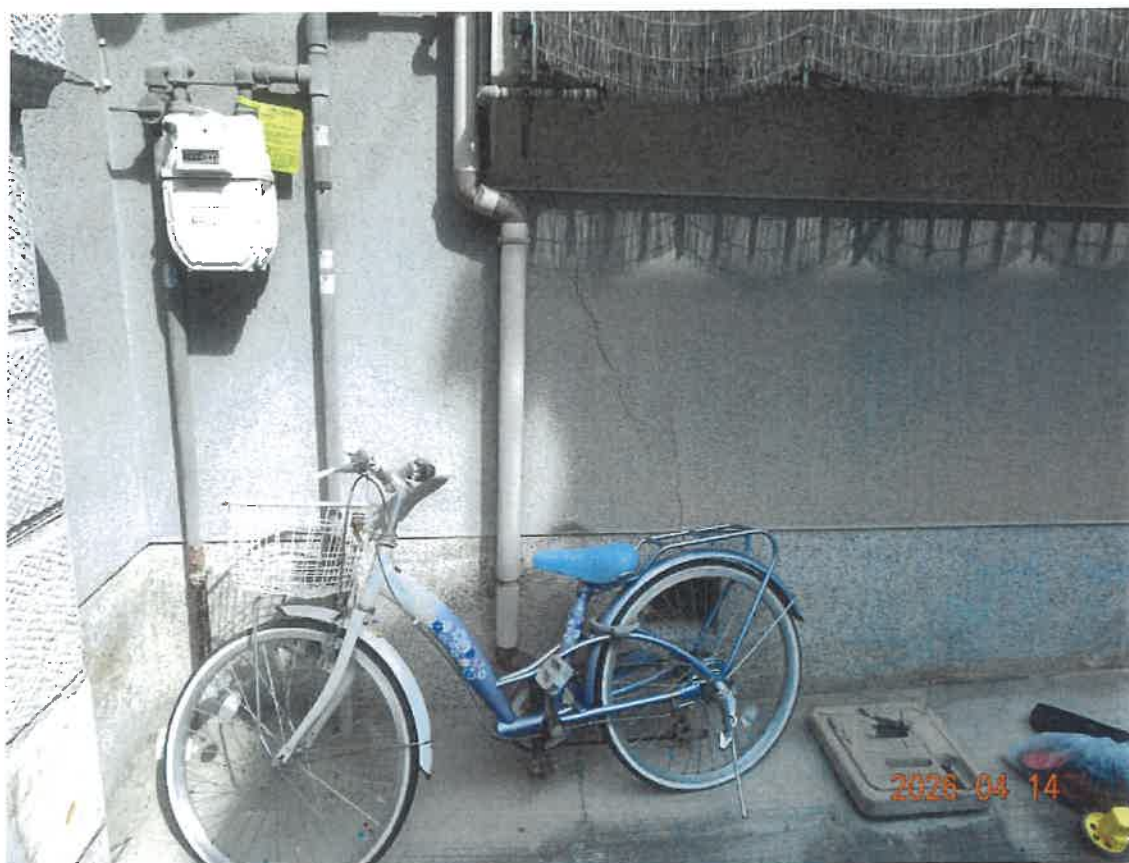
③外壁のクラック
