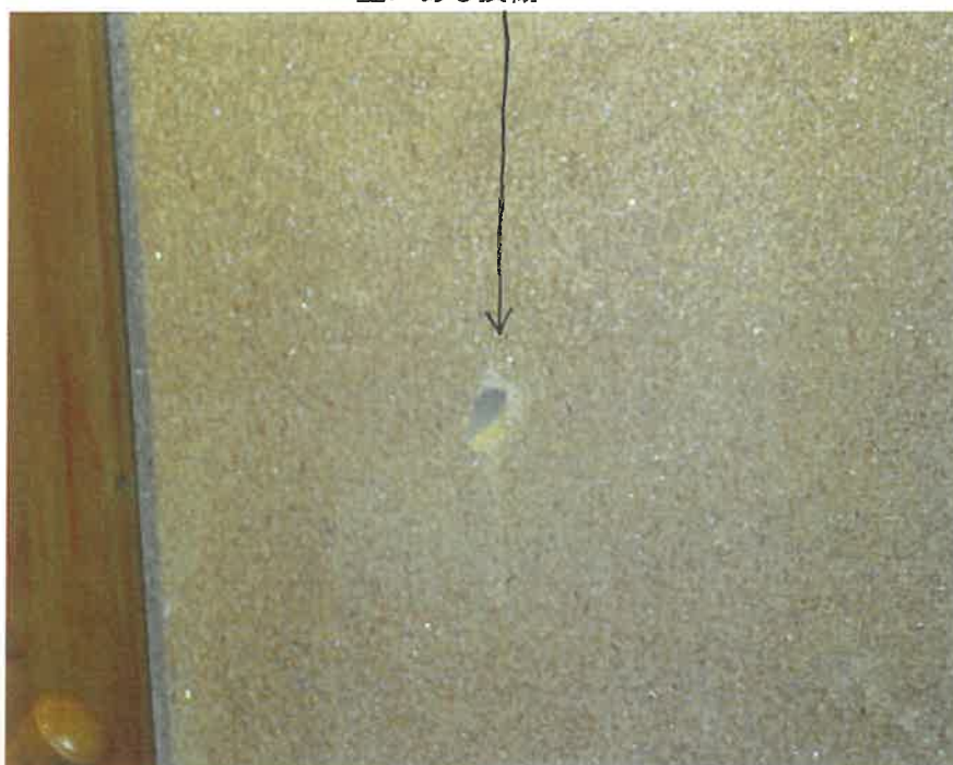
壁にある損傷
