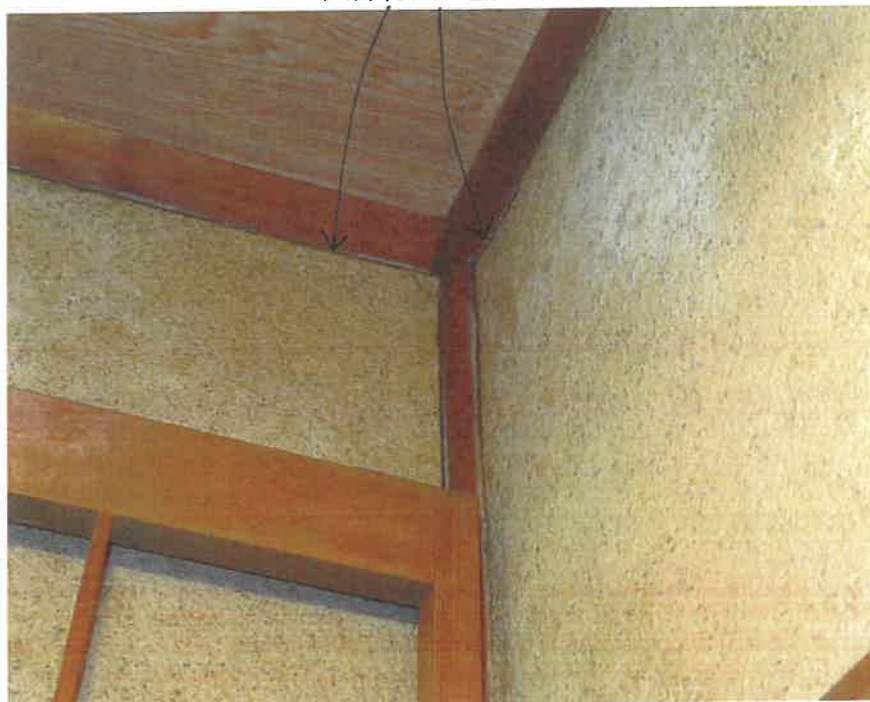
天井付近の壁にある亀裂
