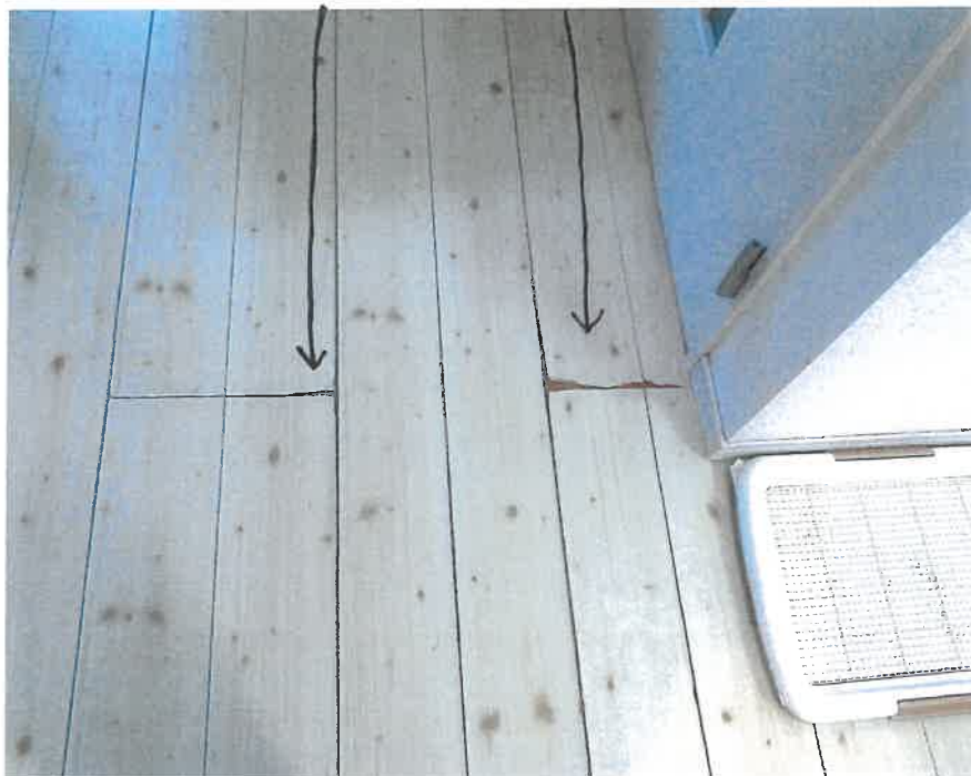
フローリングが浮いて生じたような損傷
