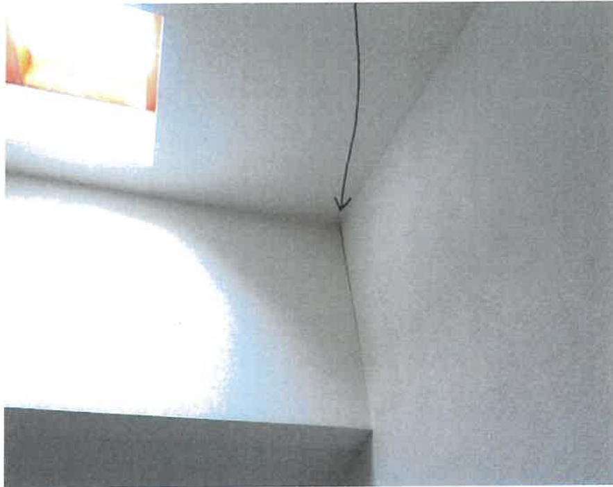
天井付近の壁にあるクロスの間
