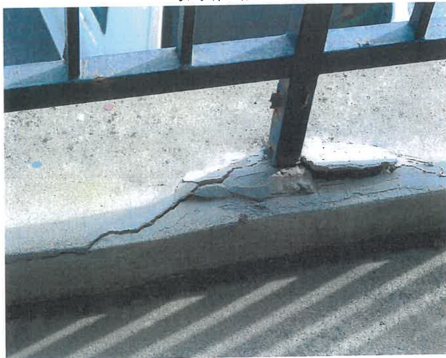
ベランダ床の縁にある損傷
