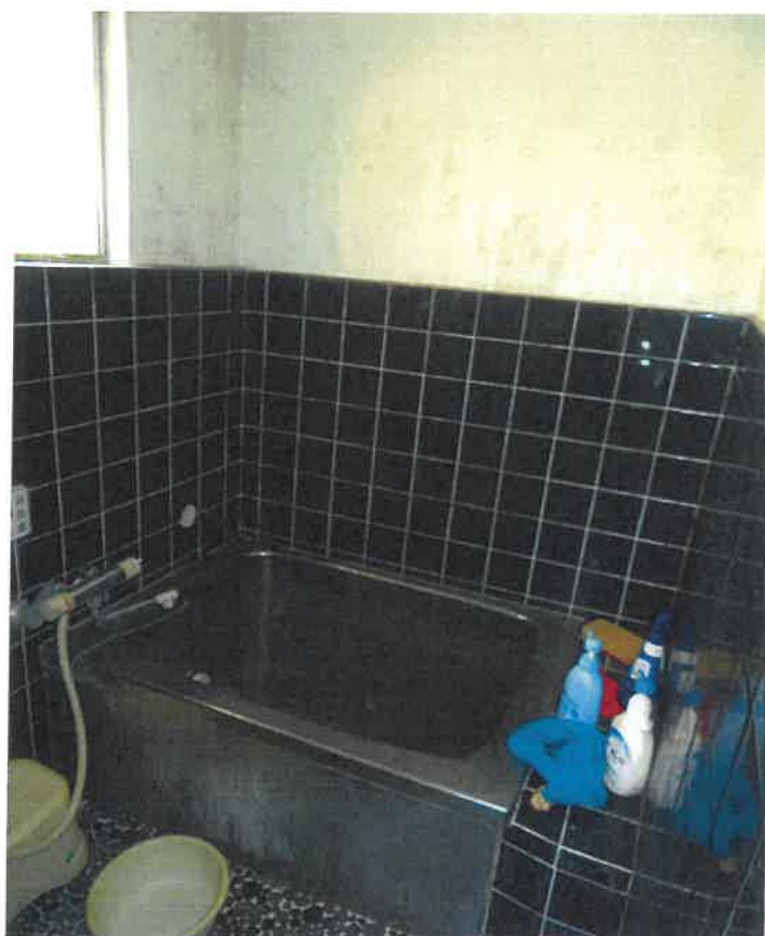
天井のカビ汚れ等
