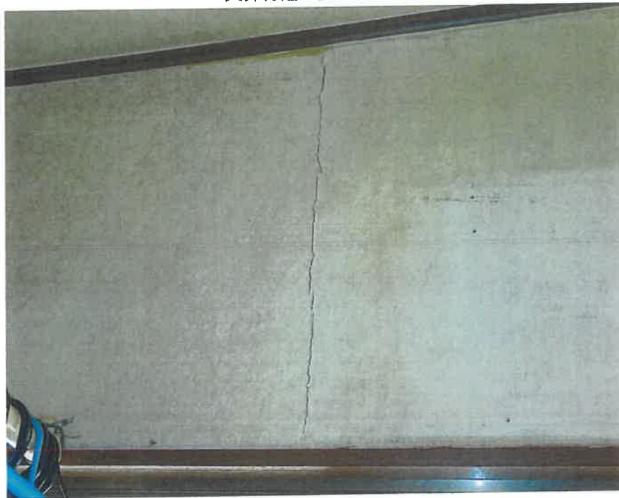
天井付近の壁にある亀裂
