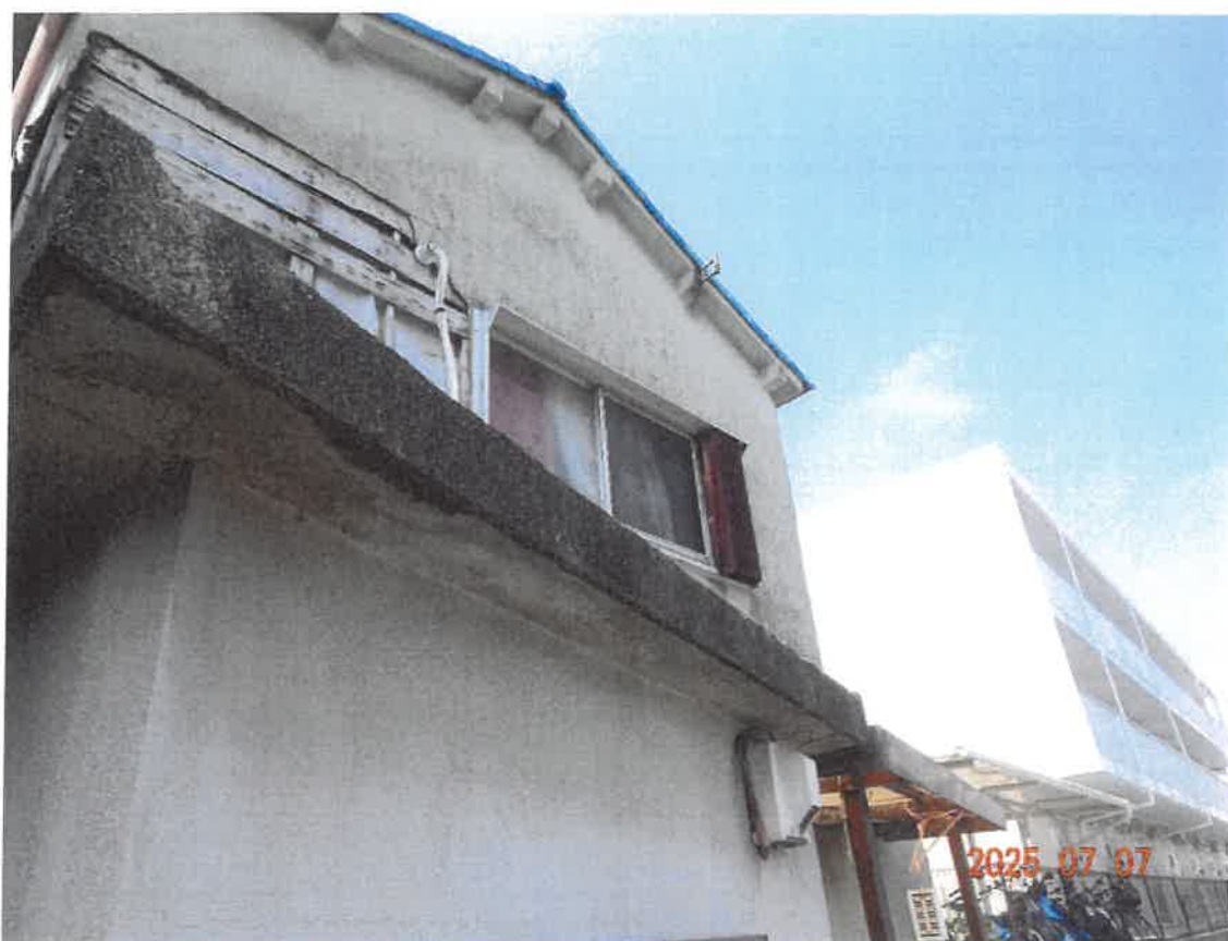
⑤外壁の損傷部分
