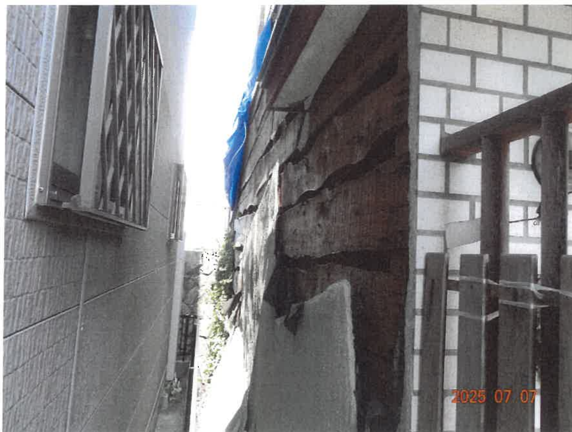
④ 外壁の損傷部分
