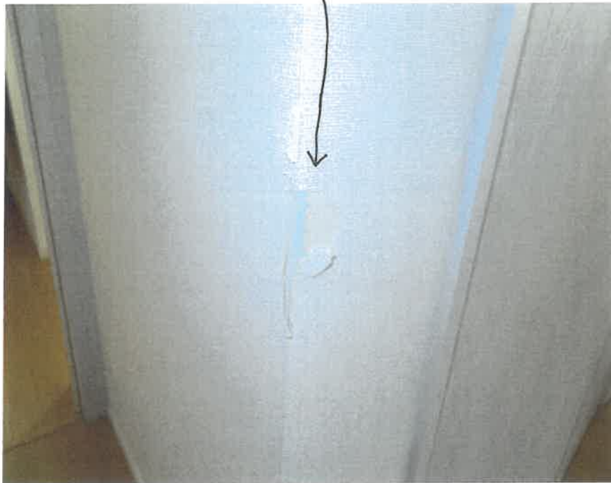
壁クロスの損傷
