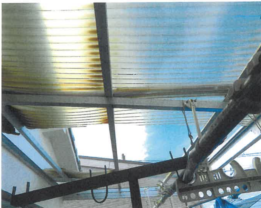
ベランダの屋根の欠損
