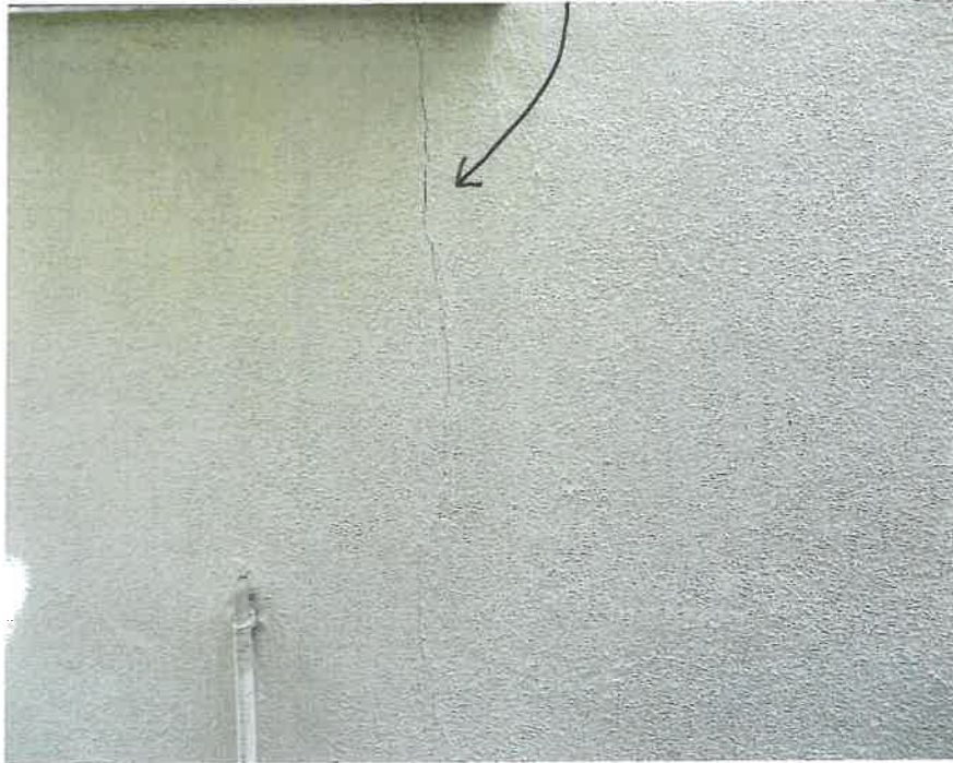
外壁にある亀裂
