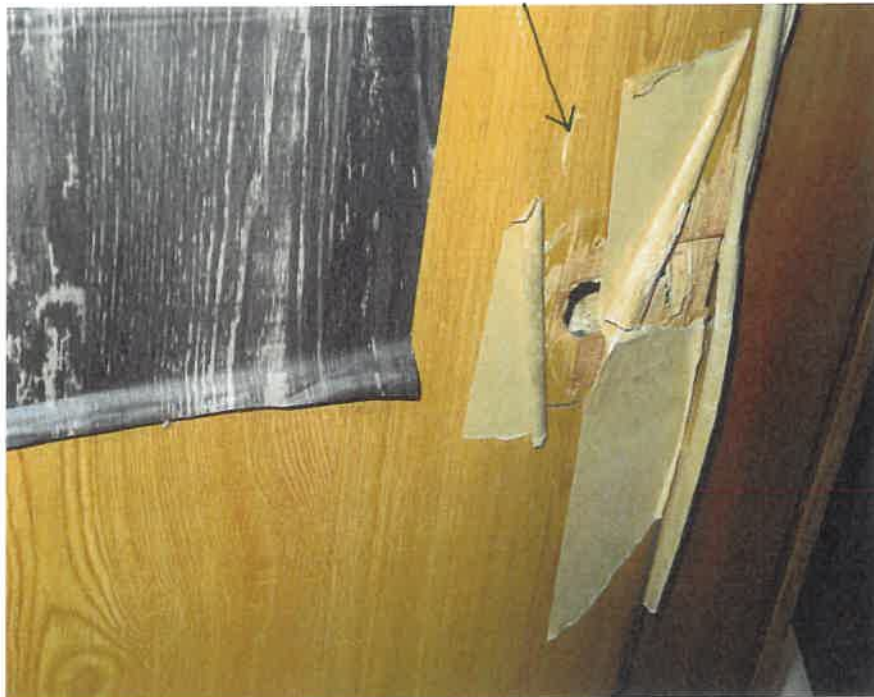
ドアノブの欠損
