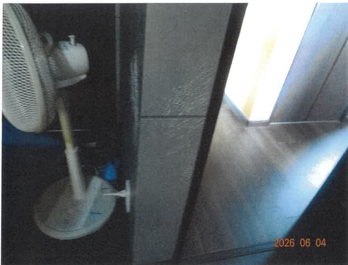
⑨壁の猫によるものと推測される損傷
