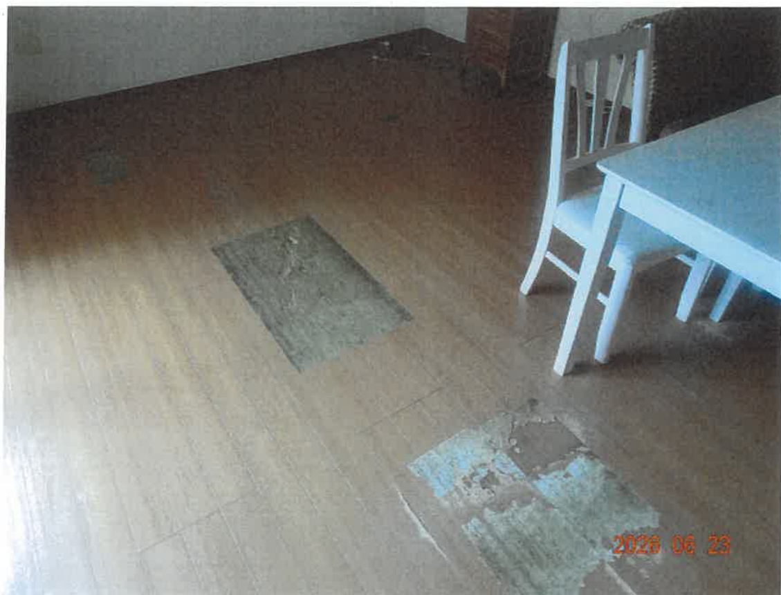
⑦床の損傷
