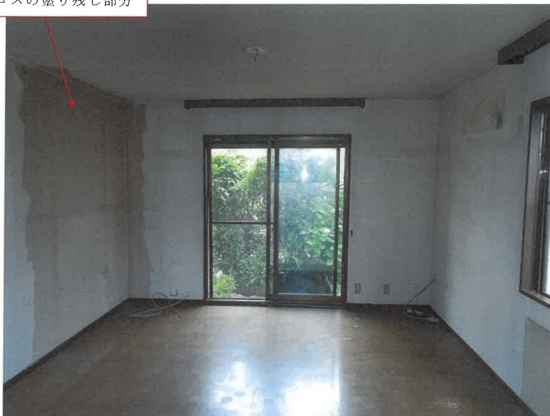
クロスの塗り残し部分
