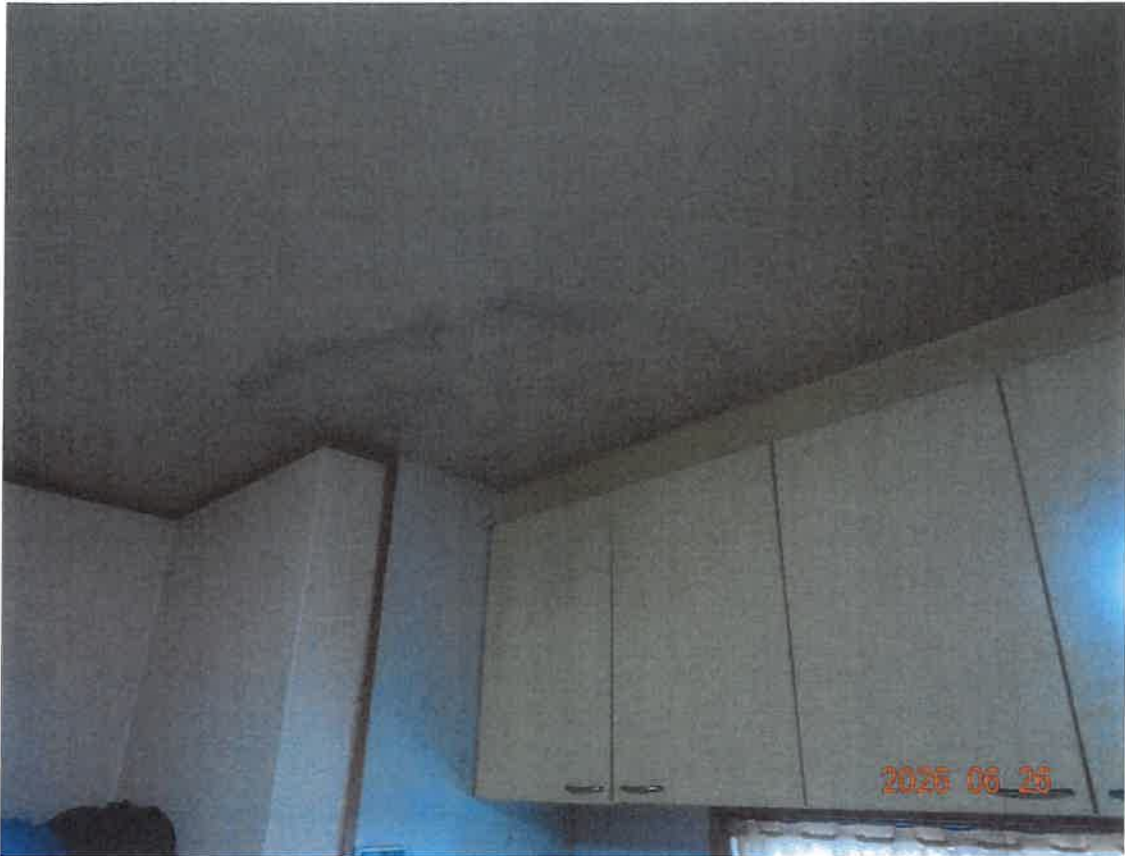
⑦キッチンの天井のしみ
