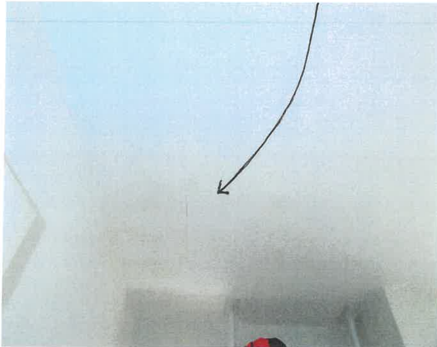
雨漏りがあるという天井(クロスの割れ目あり)
