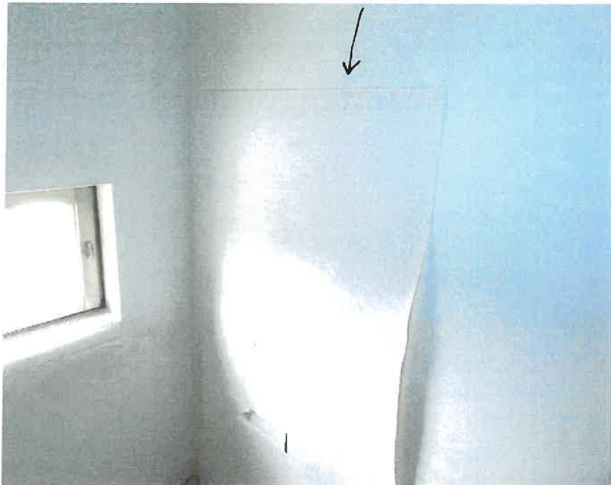
壁の損傷(穴等)に貼ってある壁紙
