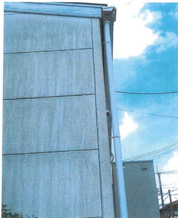
外壁サイディングの繋ぎ目等にある亀裂
