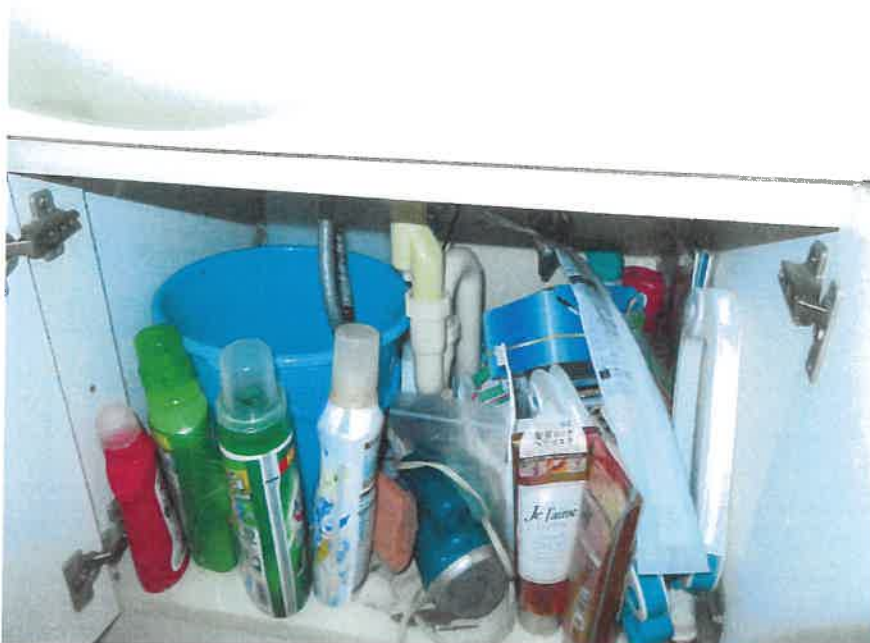
洗面台下の水漏れを受けるためにバケツを置いている状況
