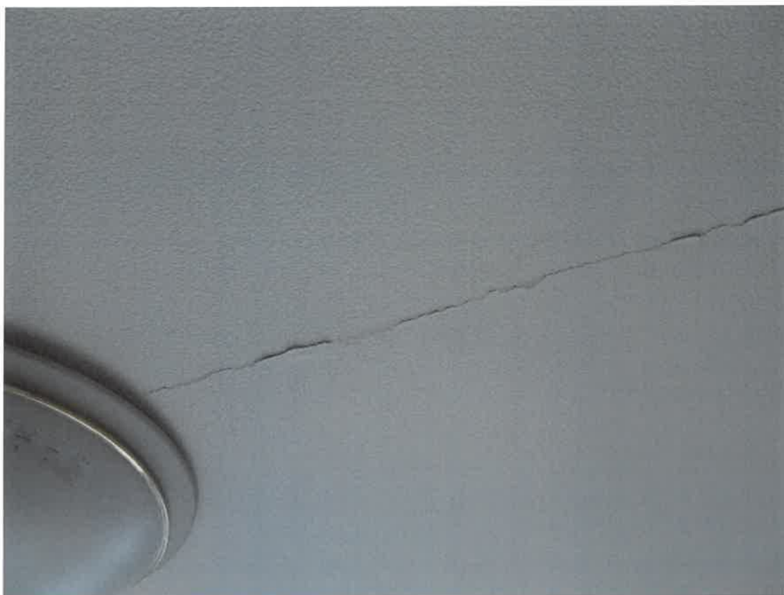
14 天井のひび割れ
