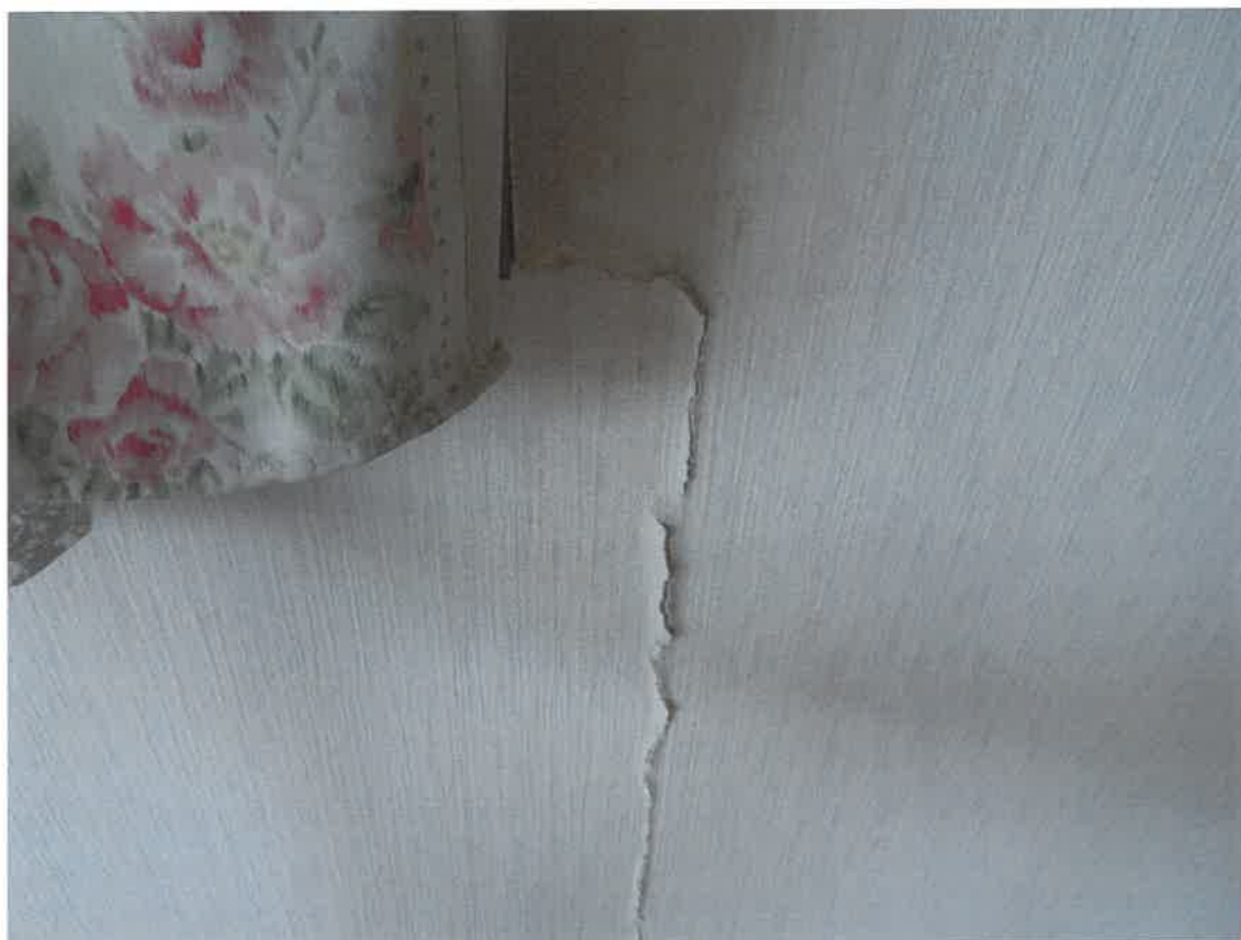
15 壁面のひび割れ
