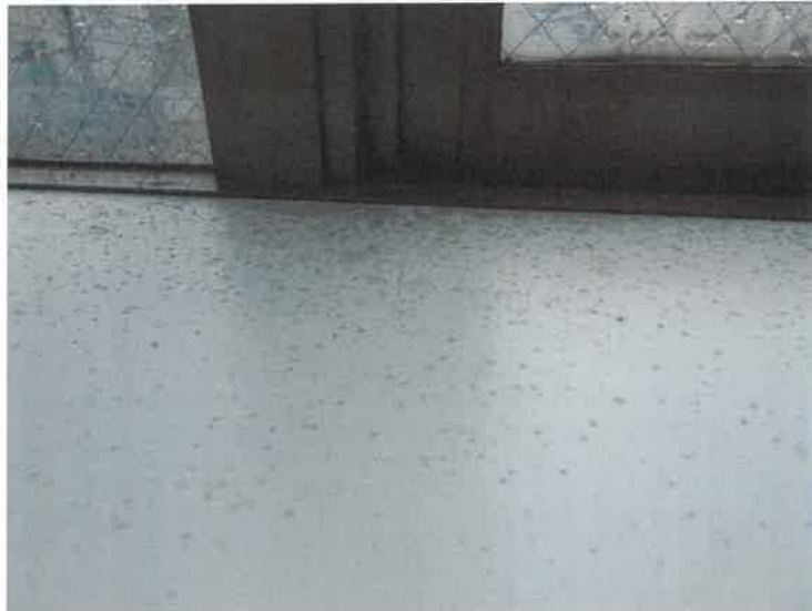
31 窓際のカビ汚れ
