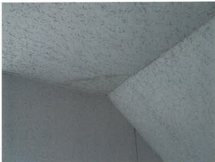
11 四階階段天井の雨漏り跡
