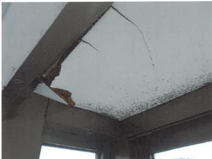
【502号室】32 天井部の損傷とカビ汚れ
