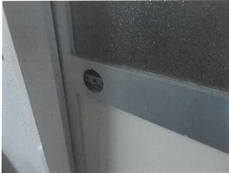
【301号室】21 浴室扉のノブ破損
