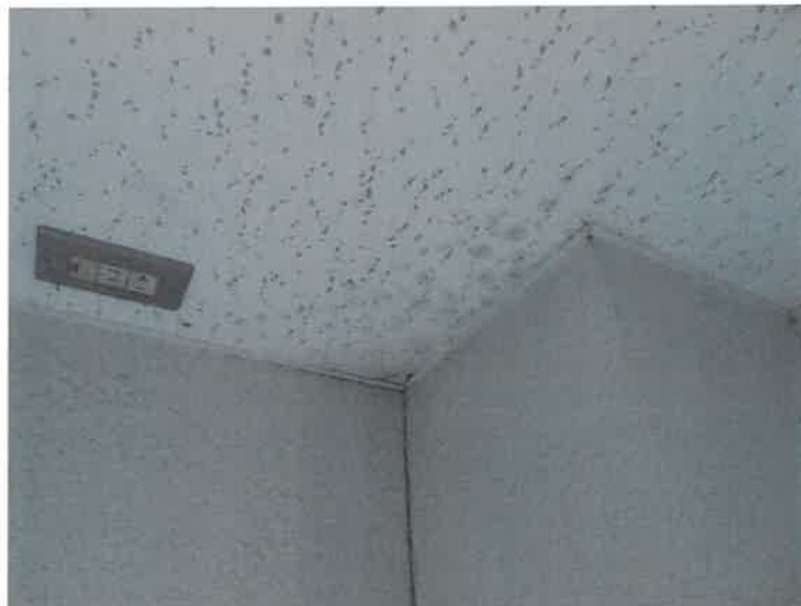
7 天井の雨漏り跡と壁面のひび割れ
