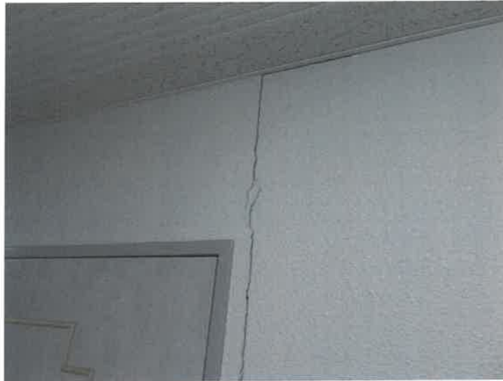
12 壁面のひび割れ(505号室付近)
