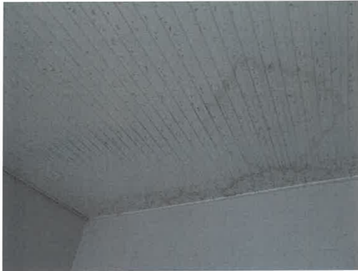
9 二階天井の雨漏り跡
