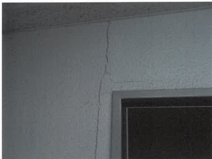
8 壁面のひび割れ(202号室付近)
