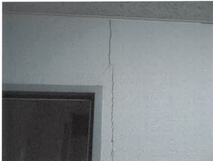
10 壁面のひび割れ(305号室付近)
