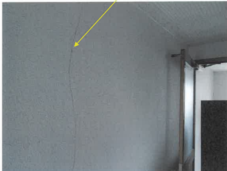
5 壁面のひび割れ
