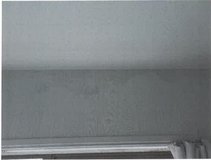
【501号室】30 雨漏り跡と思われる壁面のシミ
