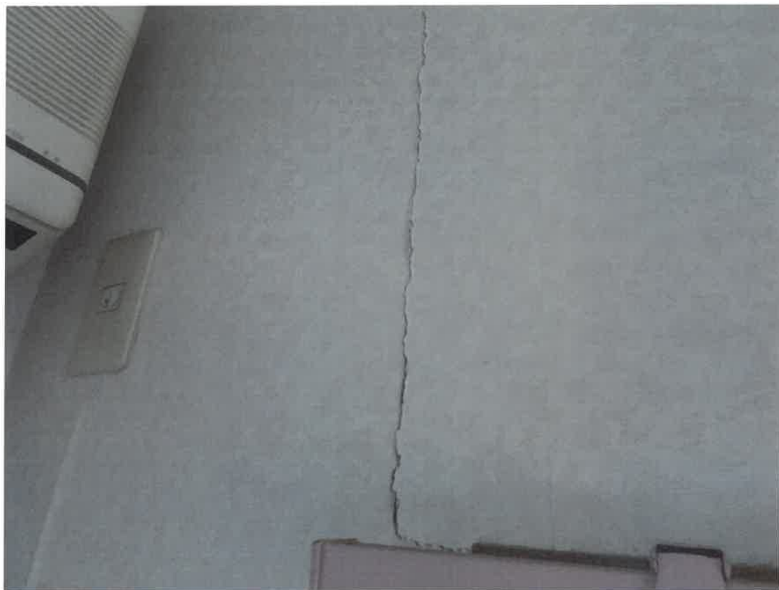
9 壁のひび割れ
