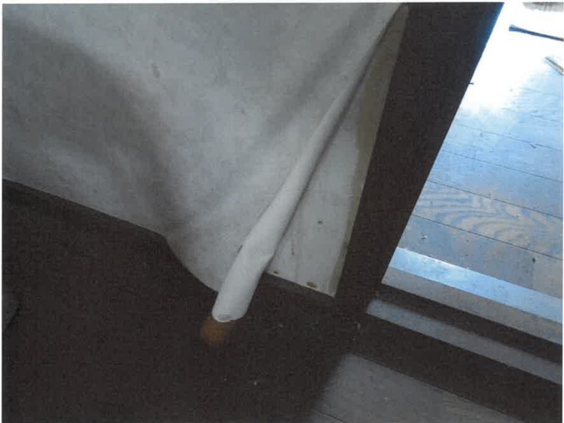
4 クロスの剥がれ
