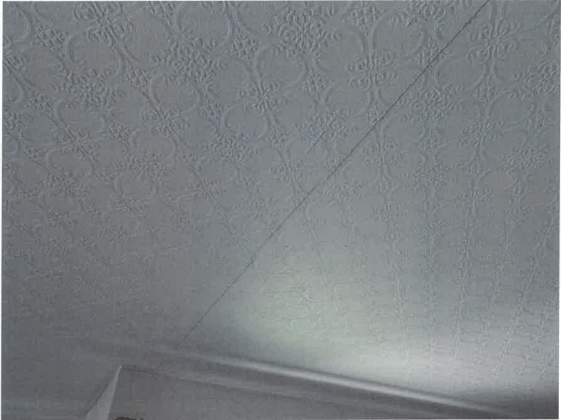
3 天井のひび割れ
