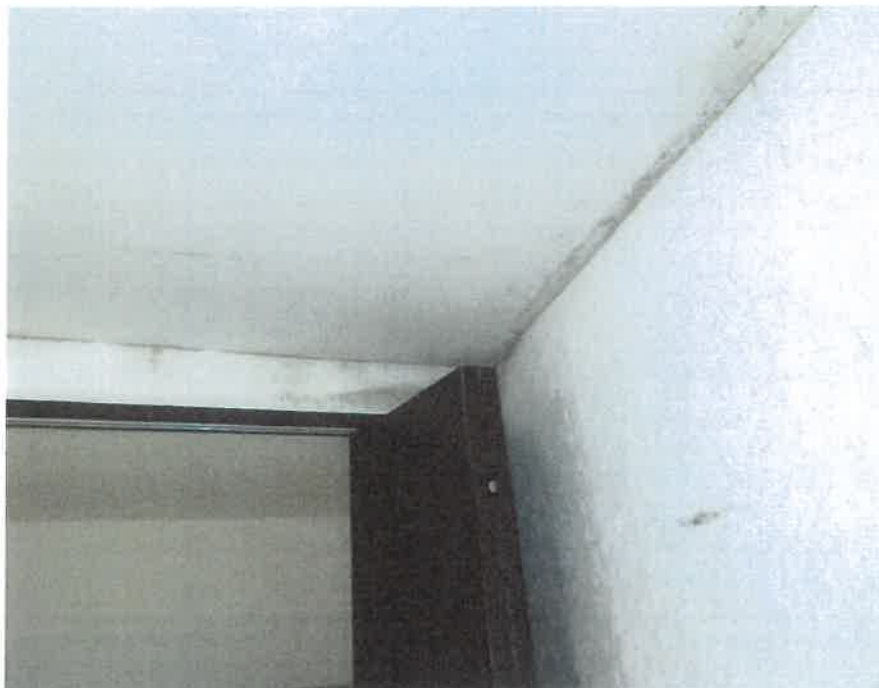
天井及び壁の黒カビ汚れ
