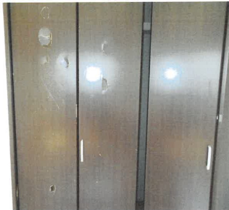
クローゼット(CL)扉の損傷
