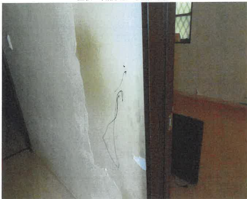
壁紙の剥離, 壁の損傷, 落書
