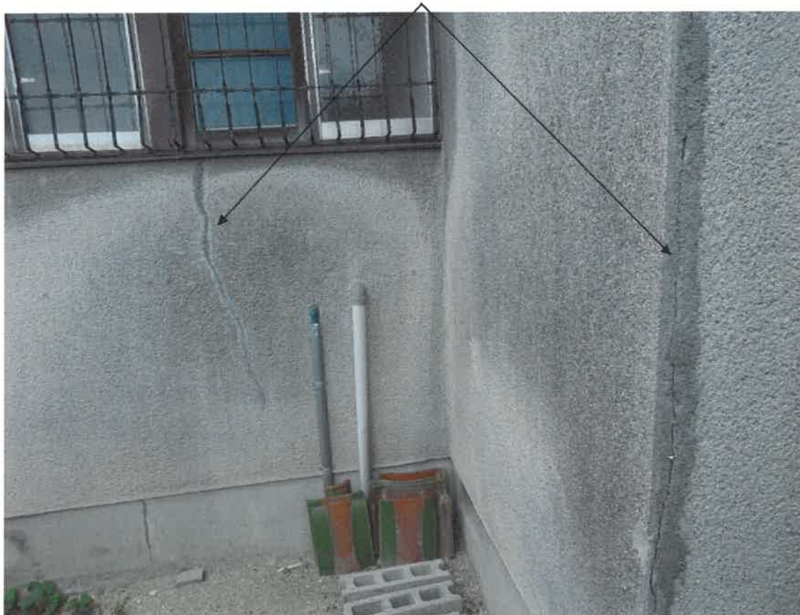
2 外壁のひび割れ
