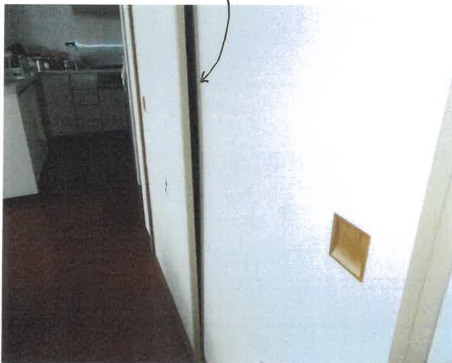
扉の湾曲による隙間
