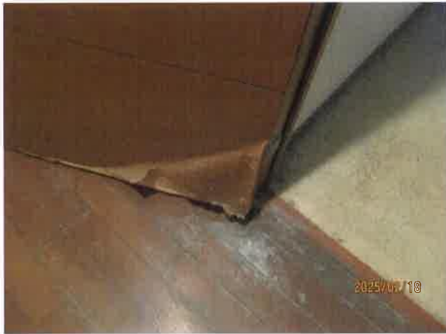
床面、建具の損傷
