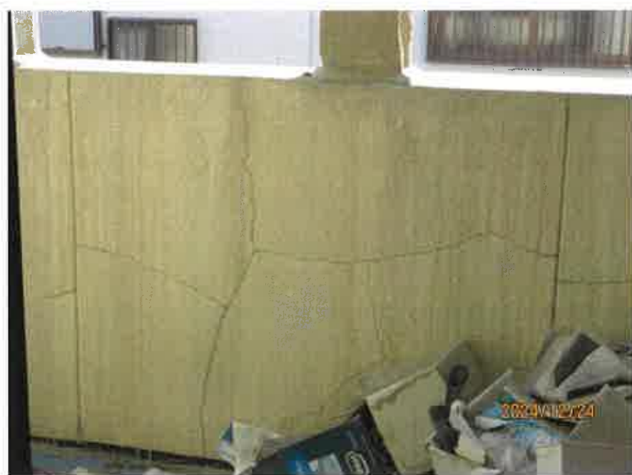
ベランダの壁の亀裂
