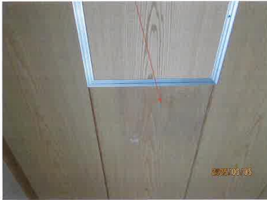
所有者が示した天井の雨漏り跡部分
