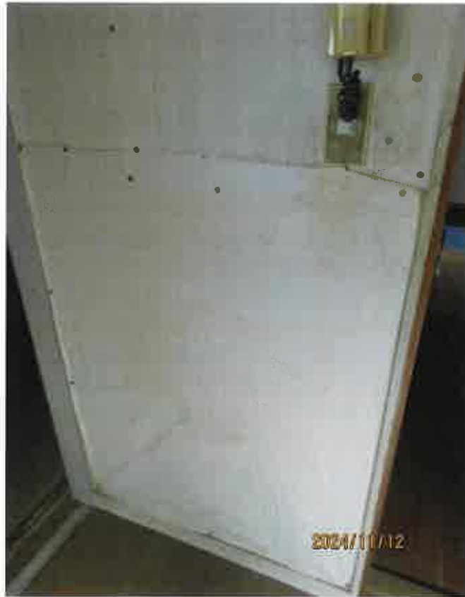
内壁の損傷と思われる部分
