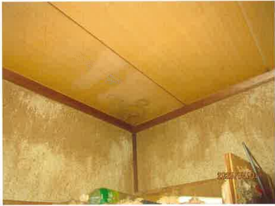
天井のシミ、内壁の損傷
