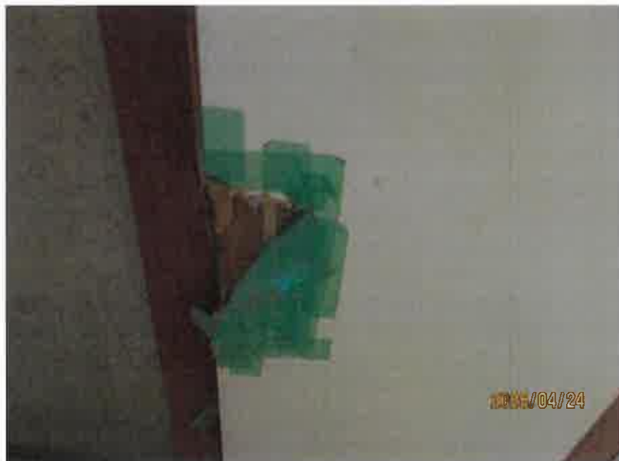
トイレの扉(取っ手)の損傷
