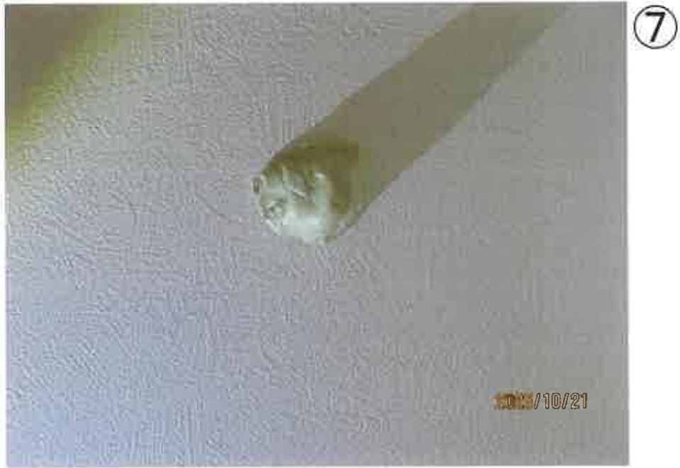
内壁の損傷と思われる部分
