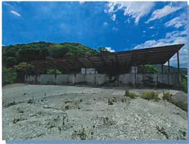
生コンプラント（骨材ヤード）
