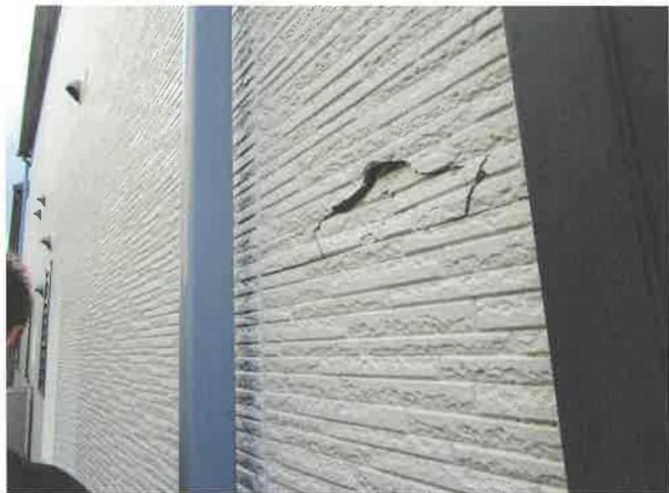
外壁の破損箇所
