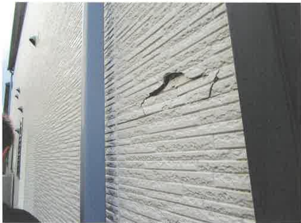
外壁の破損箇所
