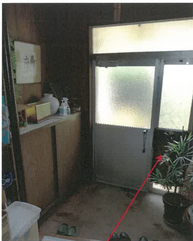
玄関のガラスが割れた部分
