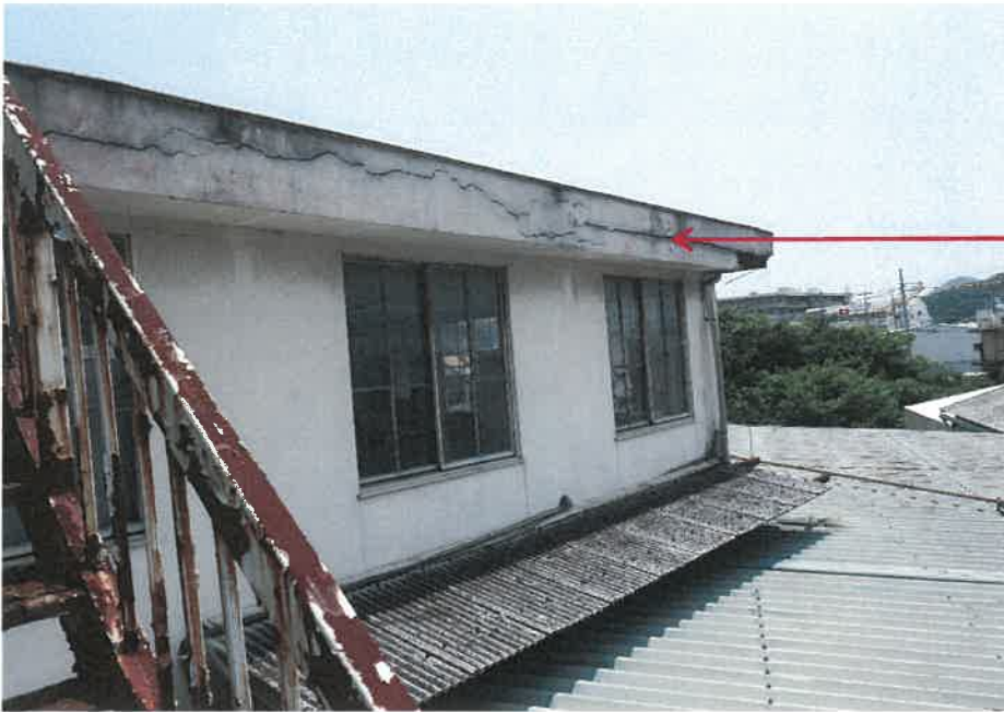
物件7の建物 陸屋根部分のクラック、剥離
