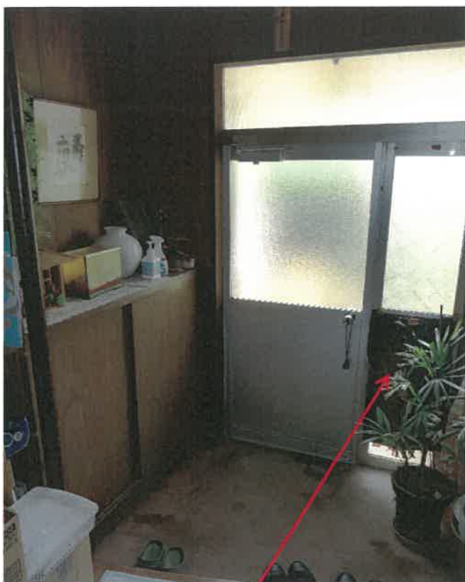
玄関のガラスが割れた部分
