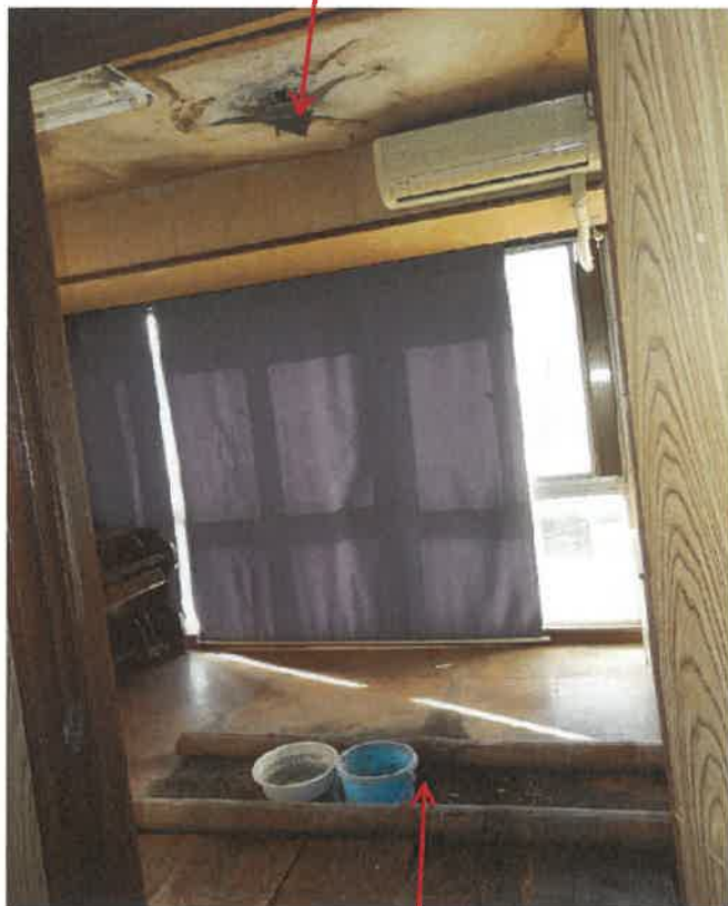
床の抜け落ち箇所
