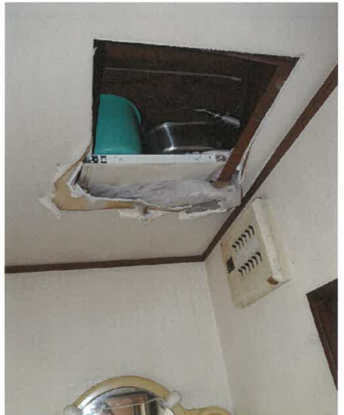
洗面所天井裏の水漏れ部分
