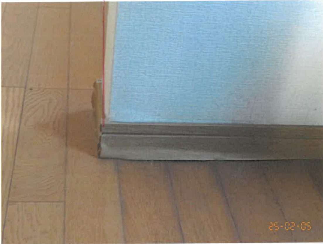
幅木が一部損壊
