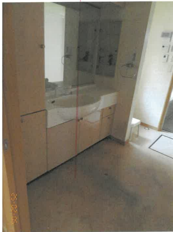
劣化等による汚れ
