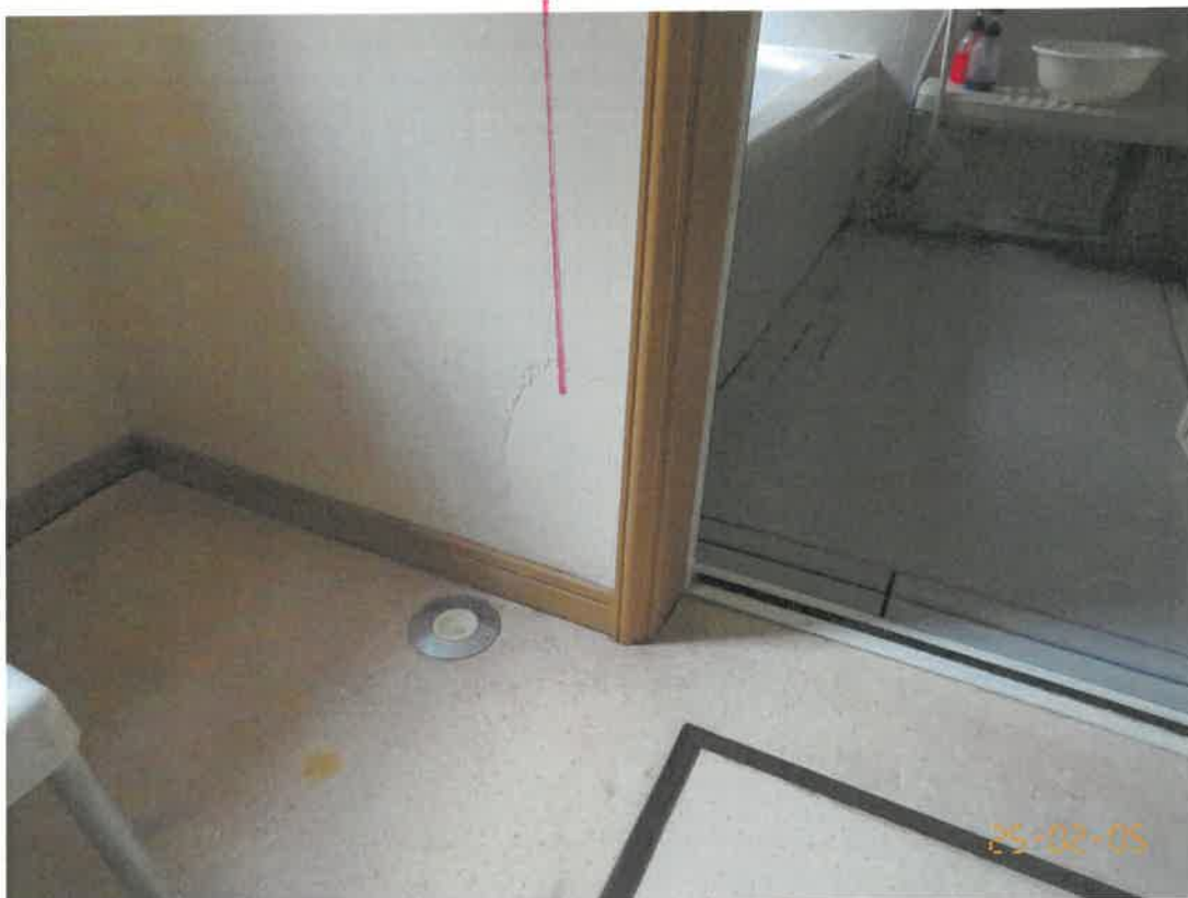
クロスの剥がれ
