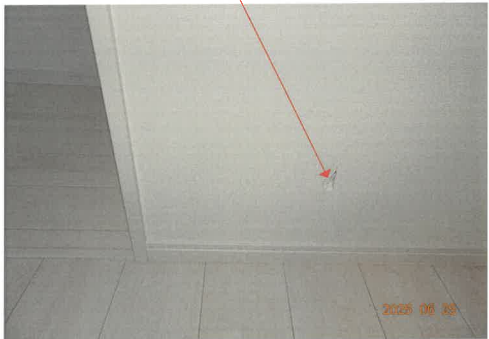
⑧ (2階中央洋室 内壁損傷箇所)
