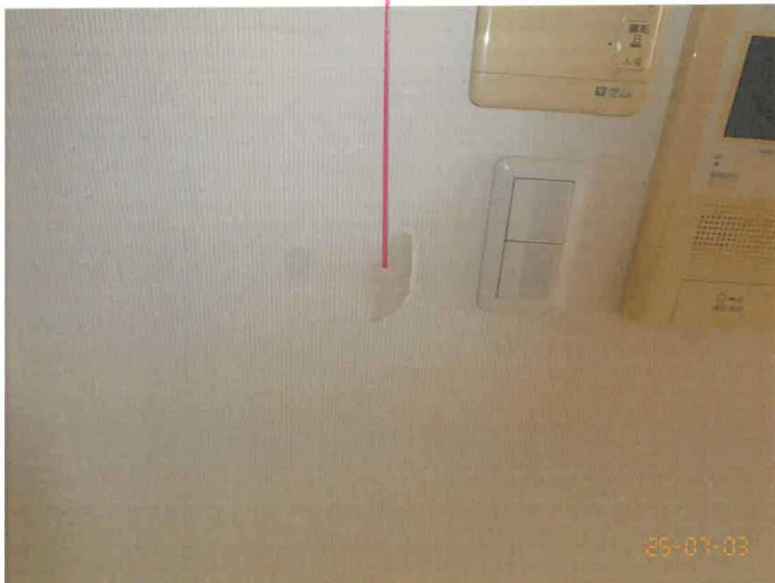
クロスの剥がれ
