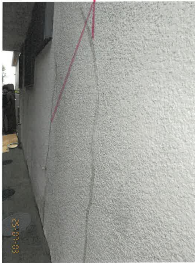
クラック補修跡
