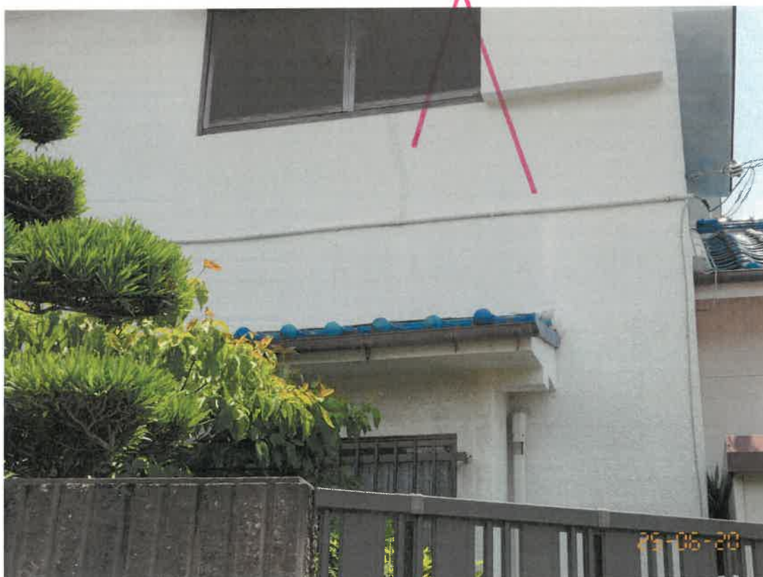
クラック補修跡
