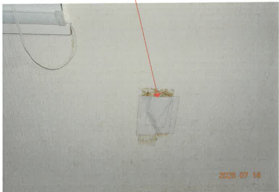
⑧ (2階東側洋室 壁の穴)
