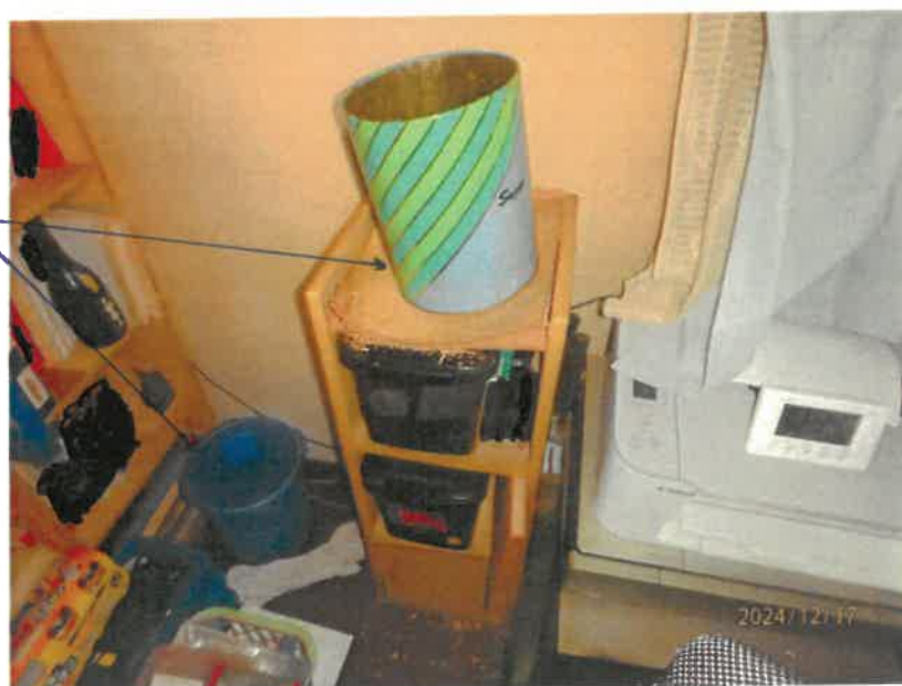
漏水があった模様
